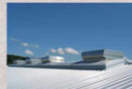
Jednostka autonomiczna na dachu fabrycznym
