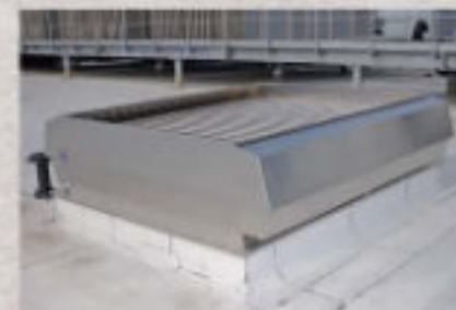
Jednostka autonomiczna na dachu fabrycznym
