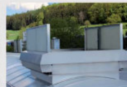
Zamontowany na szczycie świetlika łukowego
