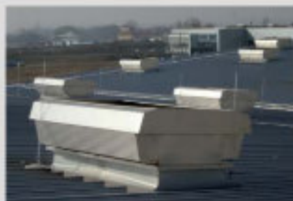
Jednostka autonomiczna na dachu fabrycznym
