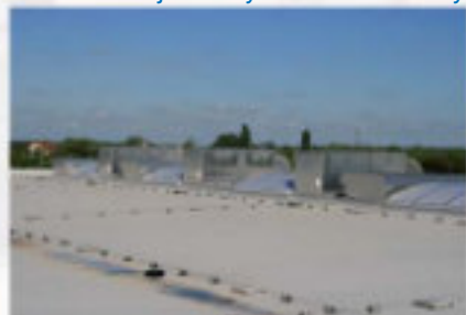
ISOVENT zamontowany na dachu
