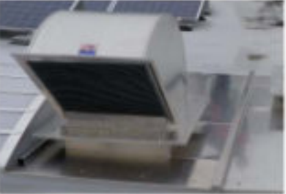
Osłona do zasysania na dachu
